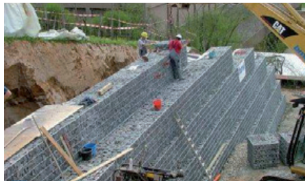
VELOCITÀ DI POSA FINO A 300 M 3 AL GIORNO INSTALLATION RATE UP TO 300 M 3 PER DAY
